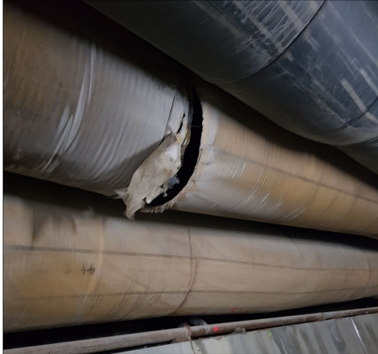
Abb. 7-12: Leckagestelle bei Lutte 2
