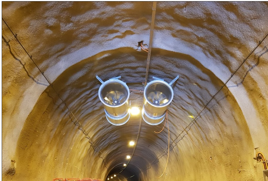
Abb. 5-5: Strahlventilatoren im EBT-W
