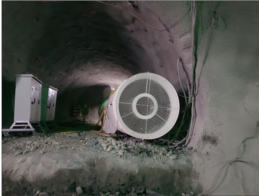
Abb. 7-11: Ventilatoren in QS 5
