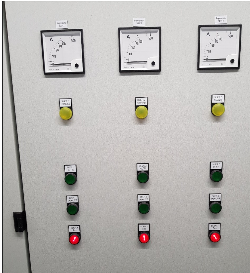
Abb. 5-6: Steuerknöpfe am Schaltkasten
