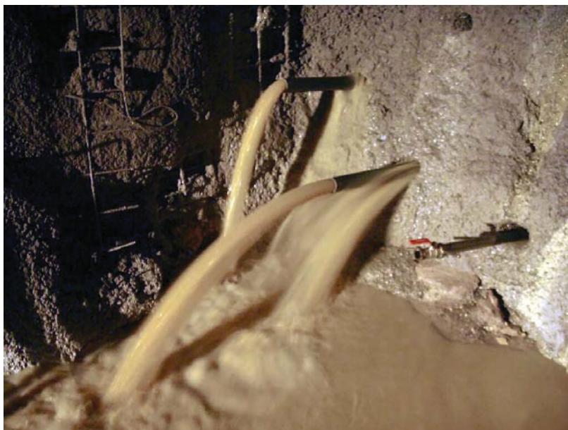
Bild 10: Wasseraustritt aus der mit Spritzbeton gesicherten Ortsbrust
