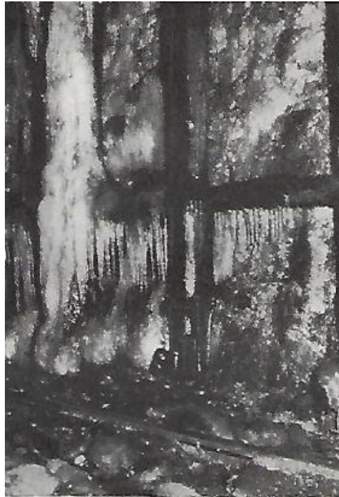
Abb. 11: Eissäulen und Bodeneis im Alten Semmering Haupttunnel [30]
