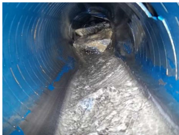
Abb. 12: Verklausungen der Ulmendrainage im Zammertunnel [52]
