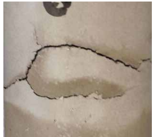
Spannungsrisse im Zement
