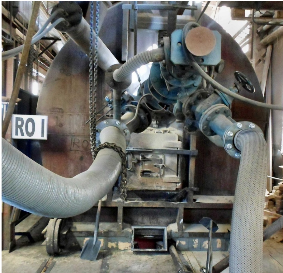
Abbildung 23: Ofenfenster (knapp über dem Boden) unterhalb des Brenners
