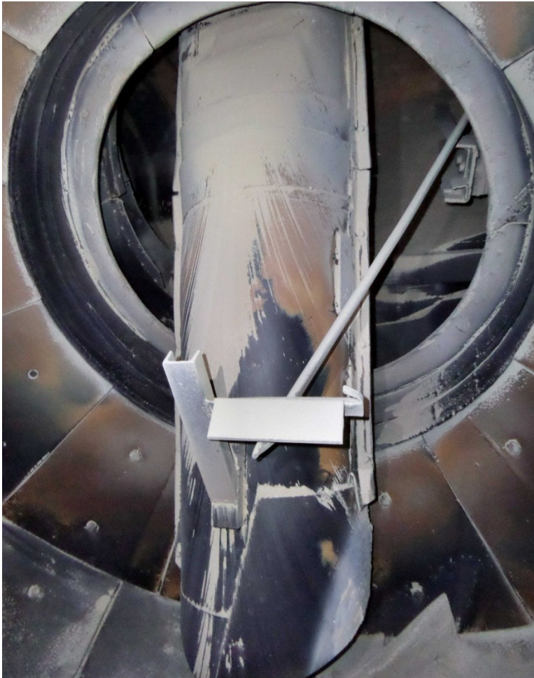
Abbildung 25: Tellerlaufbahn im Drehrohrföhrer
