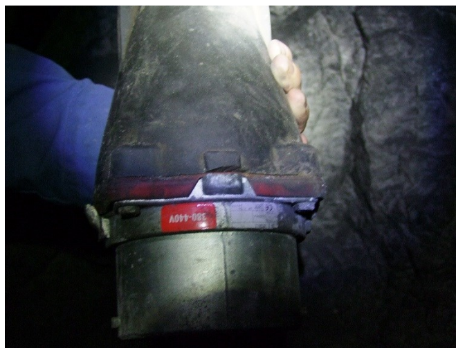
Abbildung 42: Installierte Stromversorgung auf Revier VI
