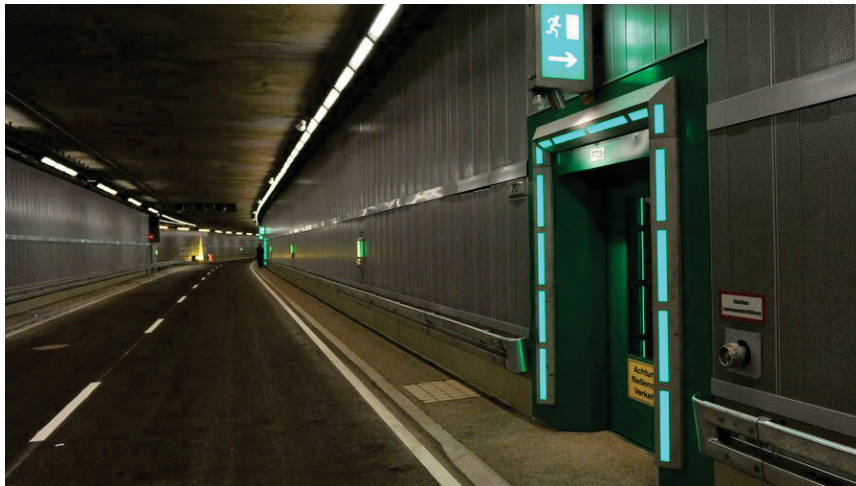
Abbildung 5-3: Notausgang im Richard-Strauss-Tunnel in München [13]
