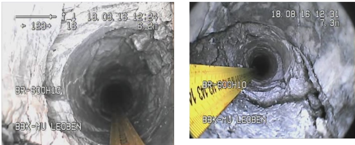
Abbildung 63: Bohrloch bei 5,2m Abstand der Strecke 600H (links) bzw. bei 6,1m (rechts)
