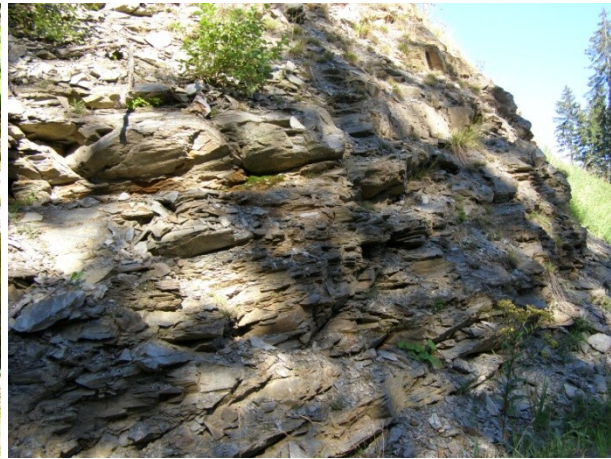
Abbildung 65: Wechsellagerung zwischen Tonschiefer und Metasandstein mit leicht in Richtung Südwesten gekippter Schieferung/Schichtung, Aufschlusspunkt 202, siehe Kartenbeilage 1.
