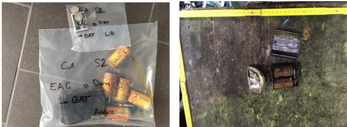
Abbildung 16: Zustand der Batterien leichte Verrostungen (links) und Austritt von Batteriesäure (rechts)
