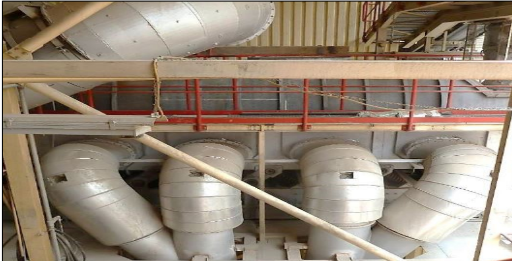
Abbildung 5-14: Ansicht des Fließbettvorwärmers [70]
