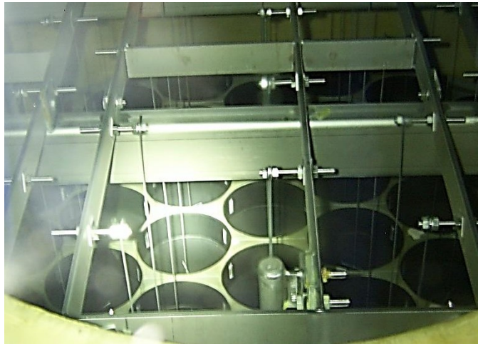
Abbildung 25: Sprühelektrodenaufhängung oberhalb der Abscheidezone
