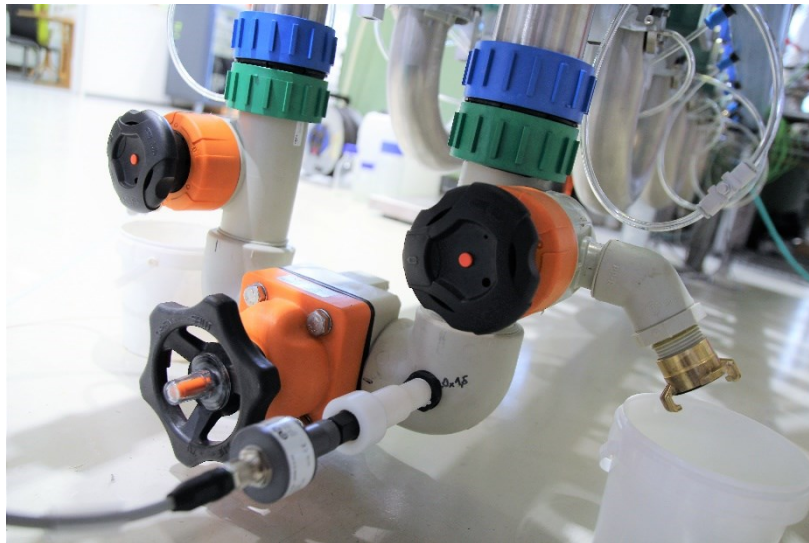
Abbildung 13 – Detail A: U-Rohr Verbindung mit Ventilen und pH-Sonde
