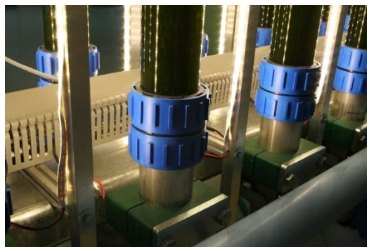
Abbildung 14 – Installation von LED-Bändern zur künstlichen Beleuchtung
