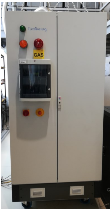
Abbildung 3-22: Schaltschrank mit Gaswarnzentrale, Notausschalter und Warnleuchten
