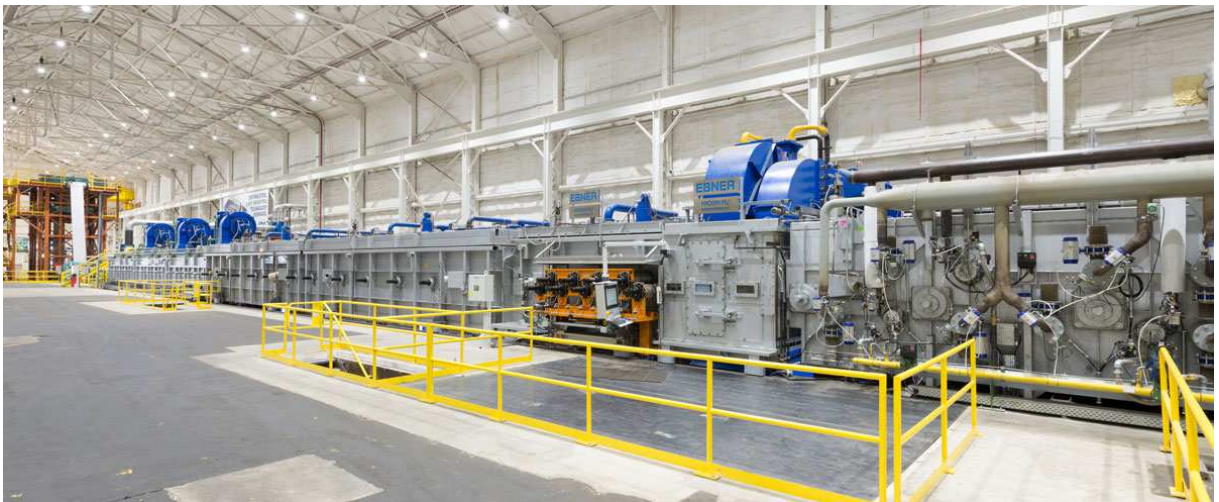
Abbildung 2.10: HyCAL -Anlage mit Jet-Kühler, Gleichrichtereinheit und Auslagerungszone [49].
