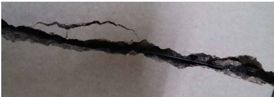
Abbildung 31: Exemplarische Rissentstehung an der Position eines Quereisens bei Versuch 16
