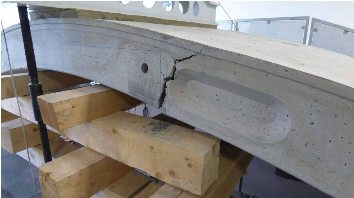
Abbildung 60: Außermittiger Riss bei Versuch 22
