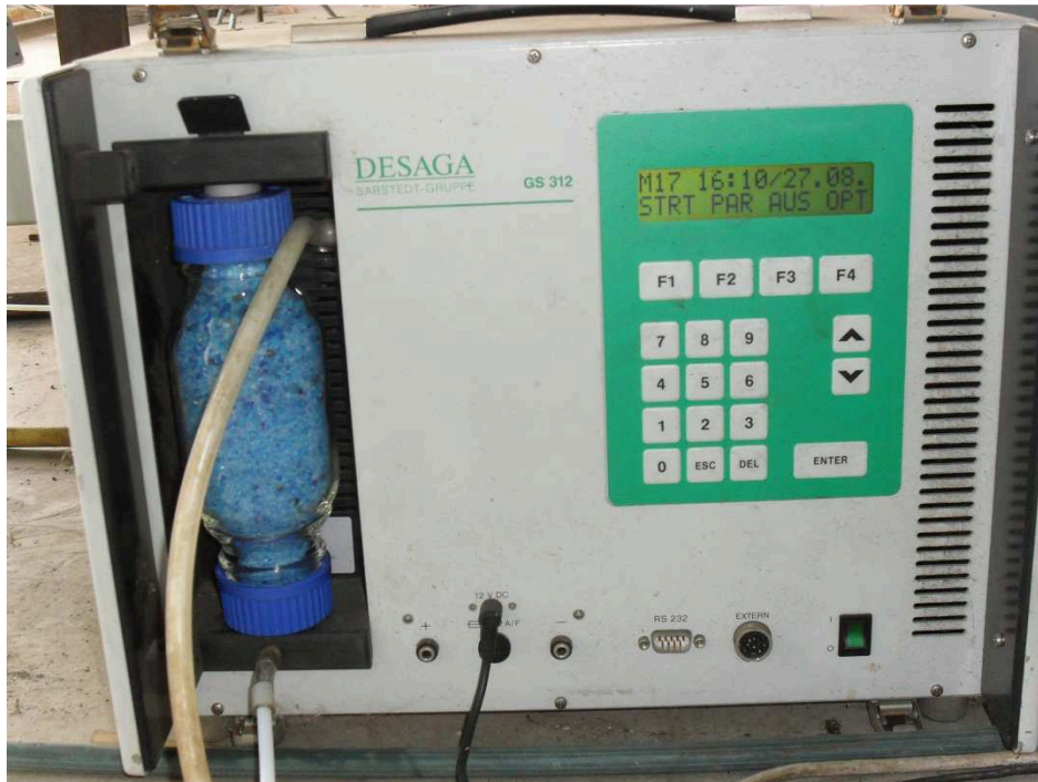
Abbildung 23: Gas-Sample-Gerät für die Feuchtemessung
