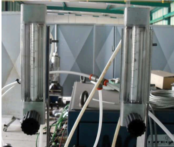
Abbildung 29: Rotameter zur NO- und Ammoniakregelung
