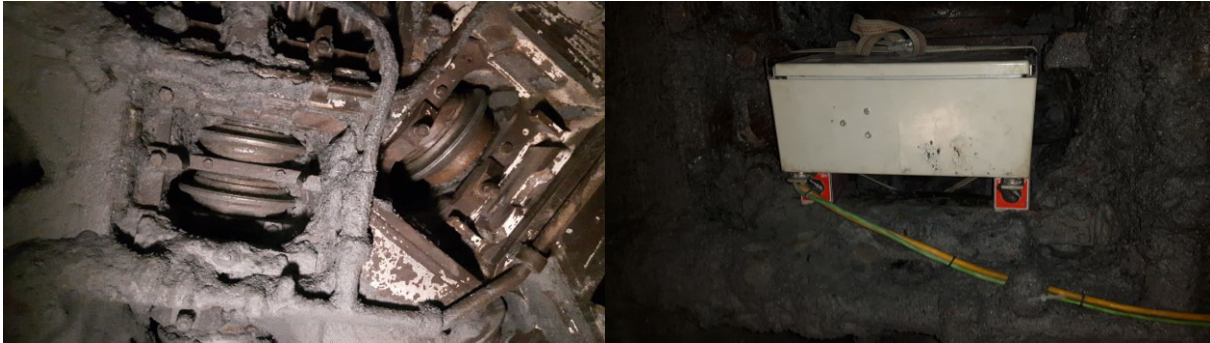
Abbildung 27: links: Doppeldiskenkasten vor Reinigung; rechts: Steuereinheit im eingebauten Zustand
