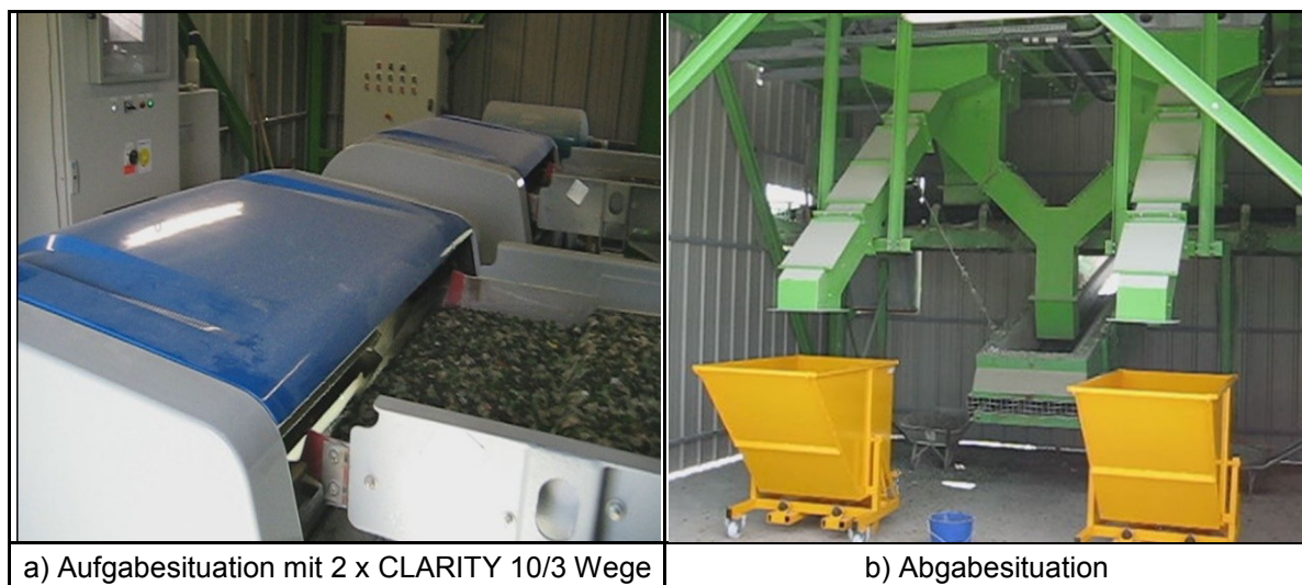
Abbildung 157: Anlageninstallation von Sortiersystemen mit GK- und KSP-Trennfunktion
