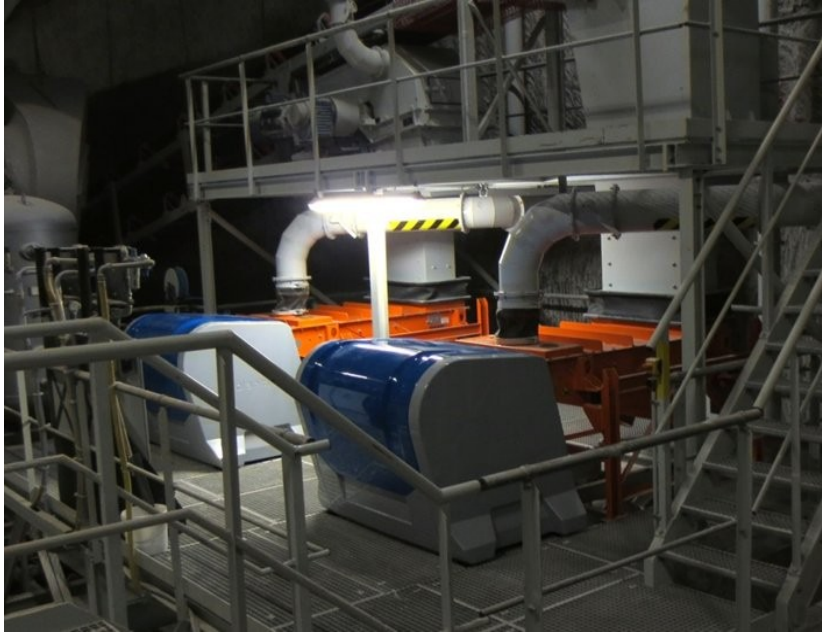
Abbildung 99: Analgeninstallation – Steinsalzsartierung (Quelle: Binder+Co AG)
