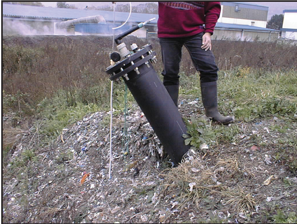
Abbildung 4.1: Richtung Böschung geneigter Gasbrunnen (35° Neigungswinkel)
