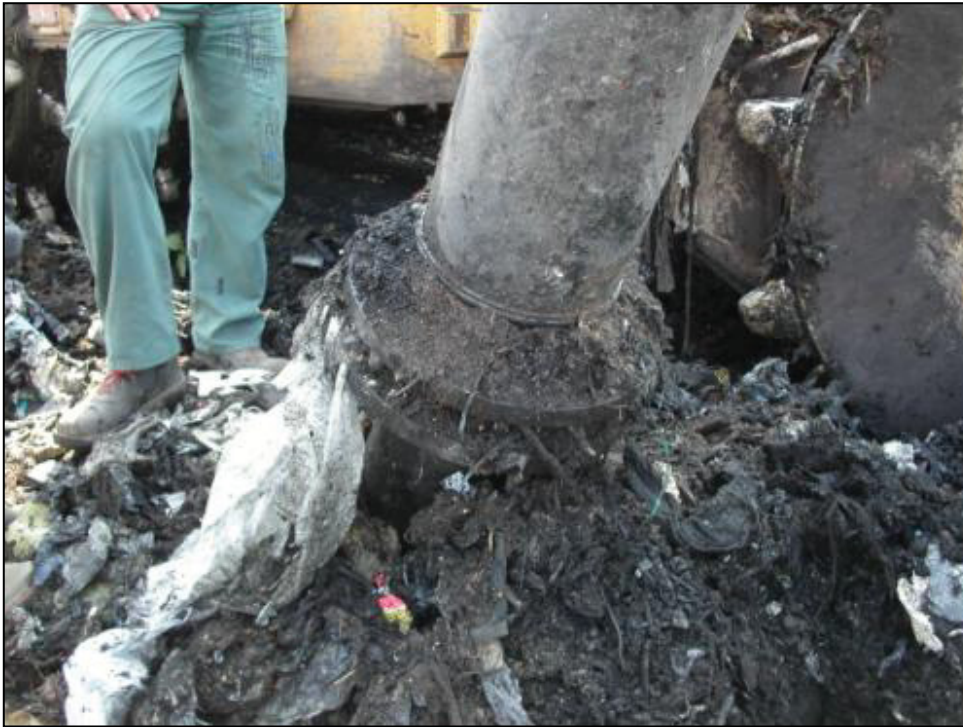
Abbildung 5.7: Verbindungsmuffe am Entgasungsrohr
