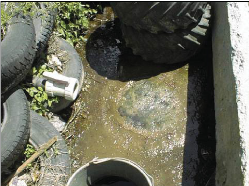
Abbildung 4.12: offenes Sickerwasserleitungsventil vor der Bewässerung, Komp. 2
