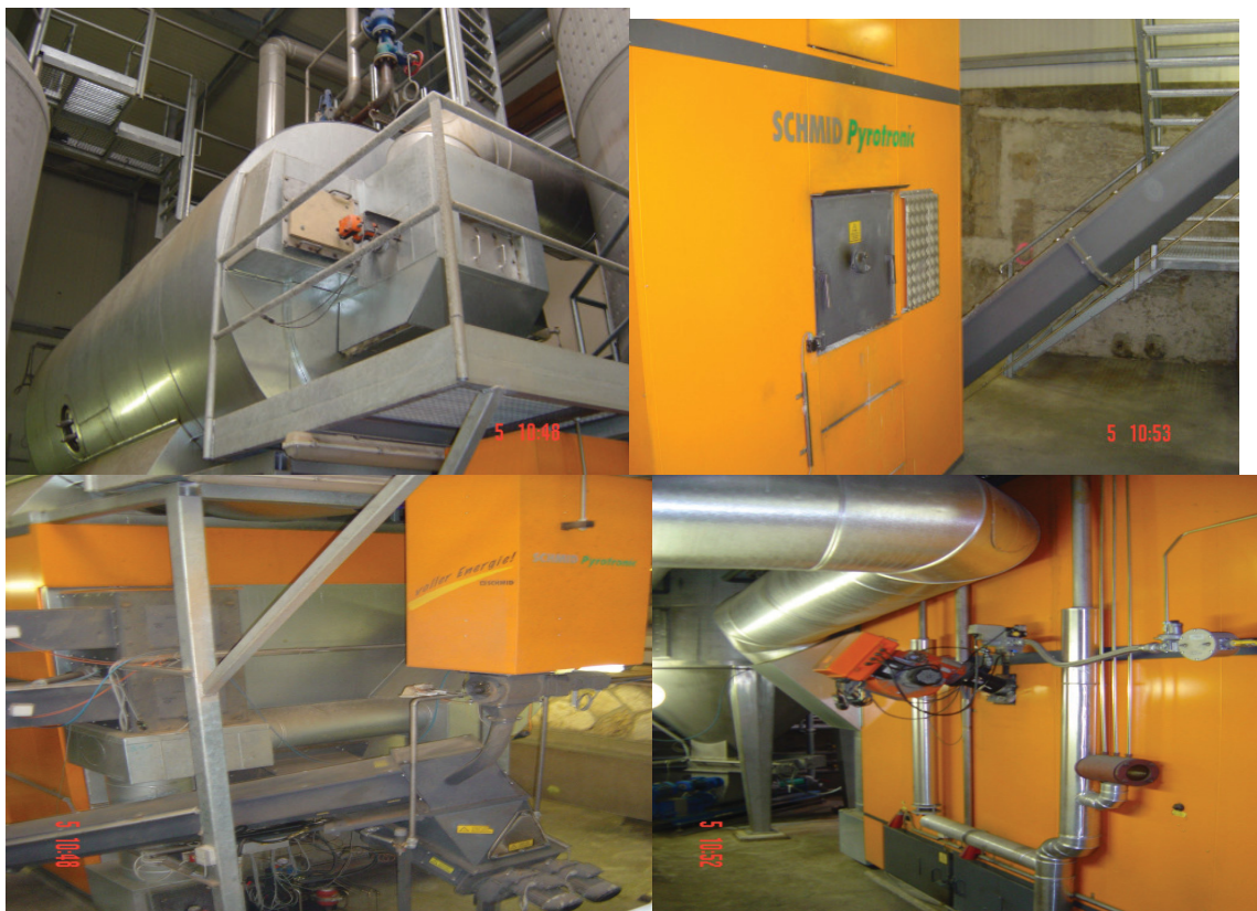
Abbildung 17: Biomassekessel der Bauerei Göss [4]
