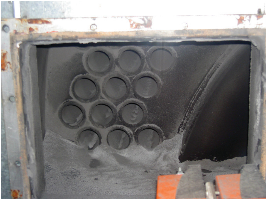
Abbildung 45: Ascheablagerung im Dampfkessel
