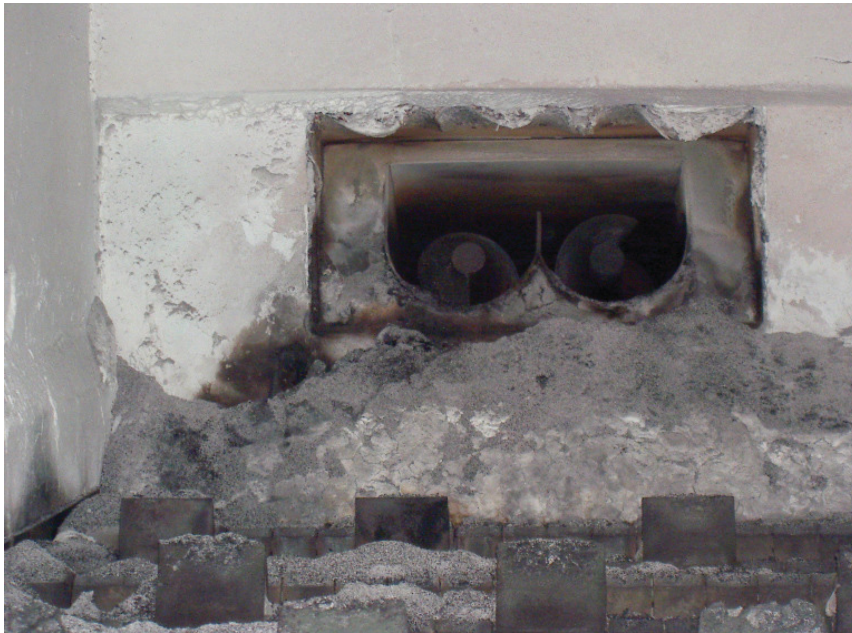
Abbildung 43: Ascheablagerung in der Brennkammer
