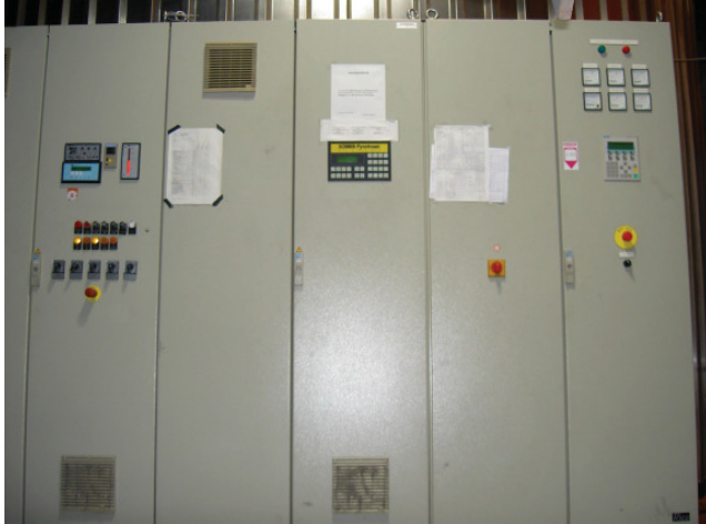
Abbildung 29: Regelungskasten der Treberverbrennungsanlage
