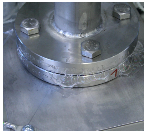
(b) Druckbehälter für Gasvorwärmung
