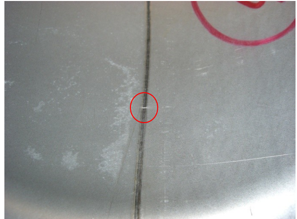
Abb. 5.28: Fehlstelle in der Schweißnaht bei VD06.
