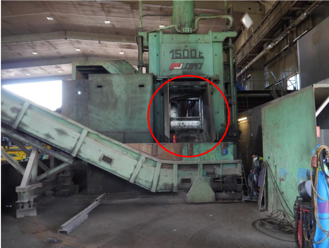
Abbildung 9: Guillotineschere der Firma COPEX von vorne; Roter Kreis: Ober- und Untermesser sowie die dahinterliegende Zuführmulde Bild entstanden bei einer Anlagenbesichtigung
