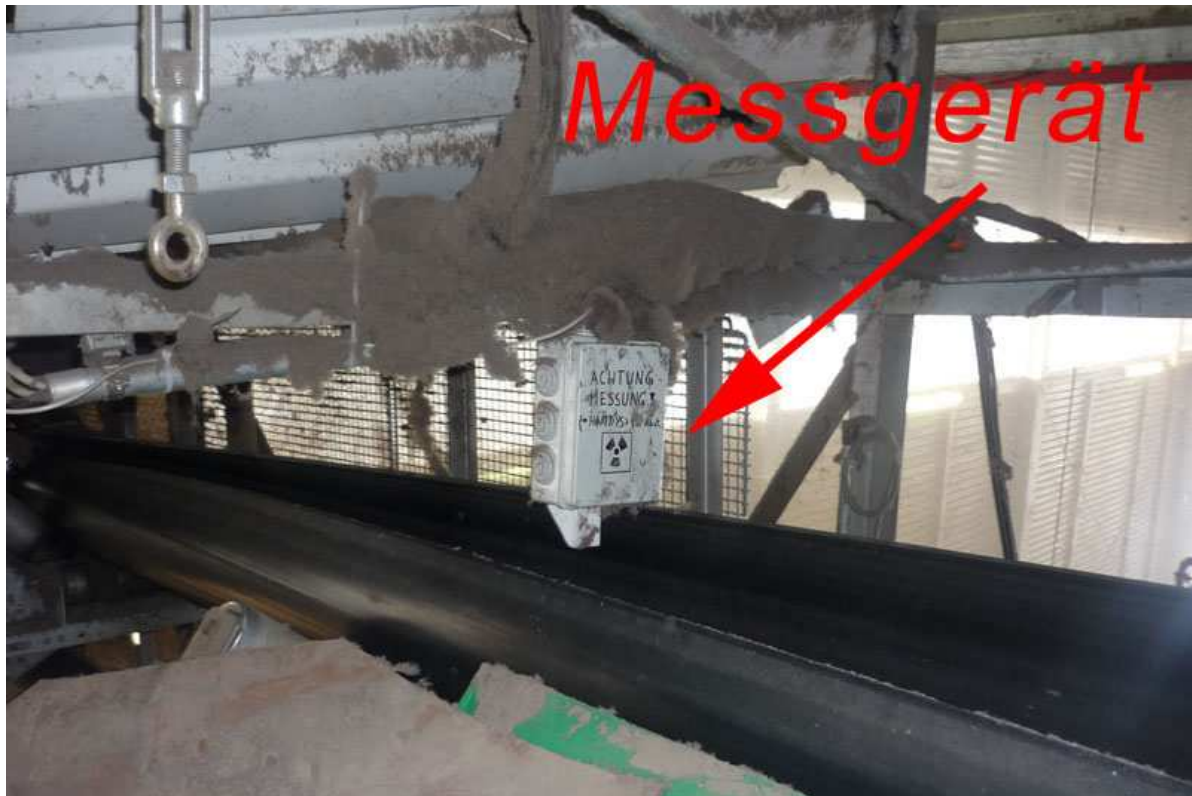
Abbildung 22: Befestigung der Messeinrichtung am Rohrgurtförderer
