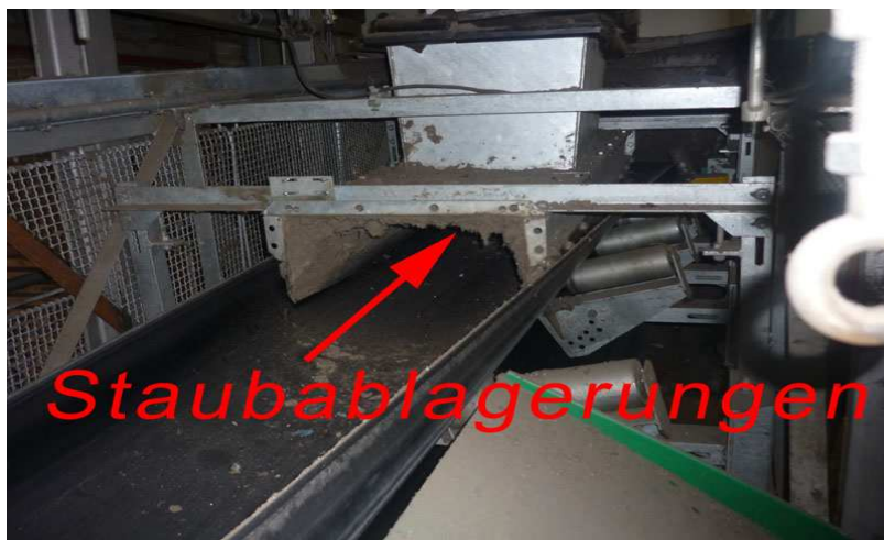
Abbildung 18: Staubablagerung am Rohrgurttförderer
