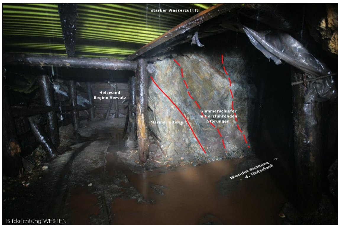
Abb. 11: Störungsbereich bei unterer Wendel Hoffnungsstollen – 4. Unterlauf
