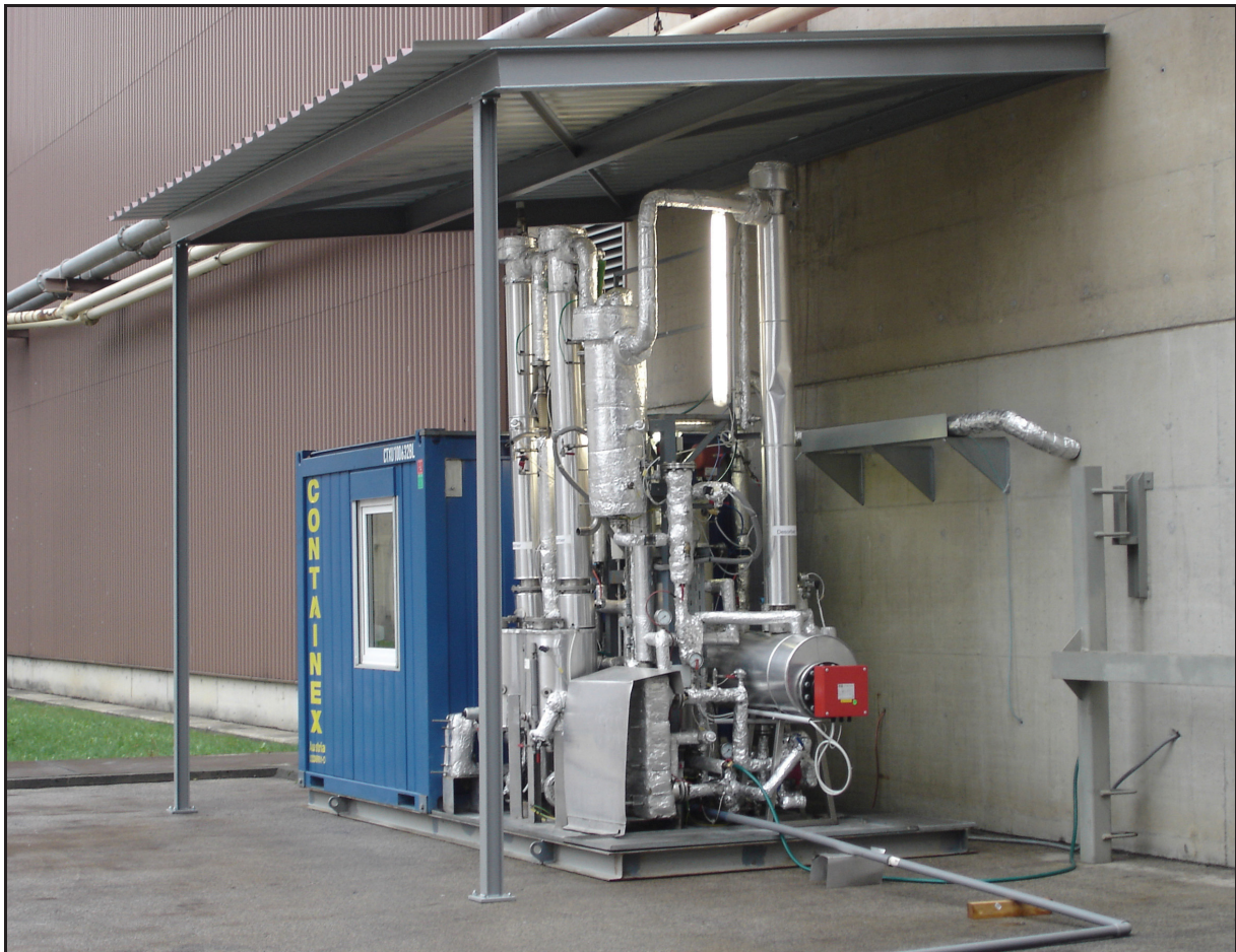
Abbildung 79: Foto der Versuchsanlage am Aufstellungsort in Dürnröhr
