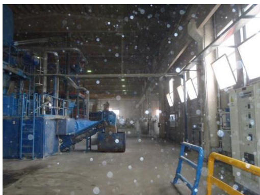
Abbildung 101: Staub im Anlagengebäude (Aufnahme mit Blitz)
