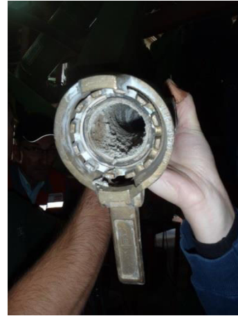
Abbildung 81: Ablagerungen im Zulaufschlauch
