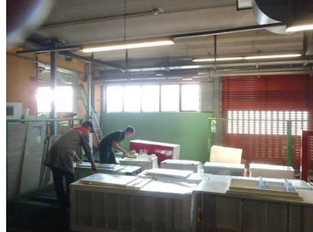
Abbildung 70: Befüllen der Kühlschränke mit Paneelen in Aufgabe-Halle
