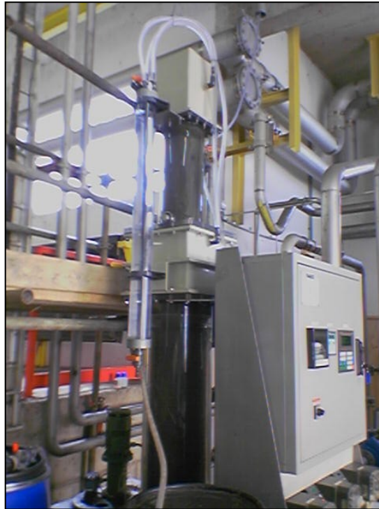
Abbildung 11: Blick auf den Reaktor bzw. die Mess- und Regeltechnikeinrichtungen [8]
