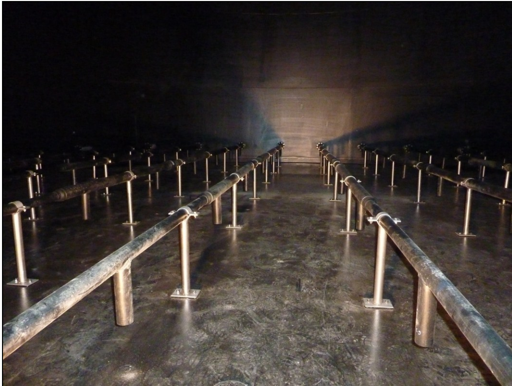
Einlaufverteilerrohre am Reaktorboden
