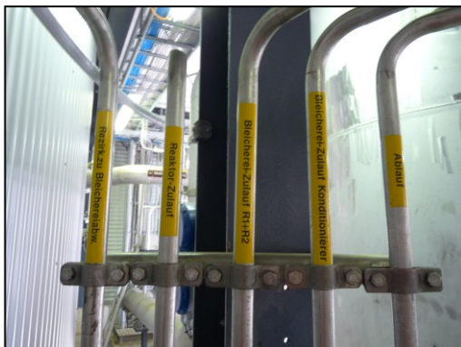
Abbildung 20: Probenahmeleitungen im Anaerobiegebäude
