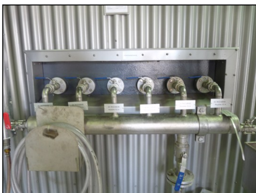
Abbildung 21: Schlammbeprobungsleitungen aus unterschiedlichen Höhen
