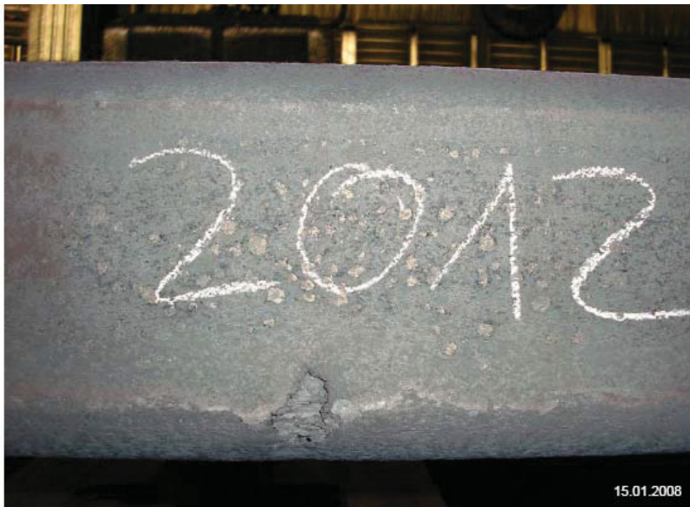
Bild 45: Massiver Kantenquerriss, Stahlgruppe 1
