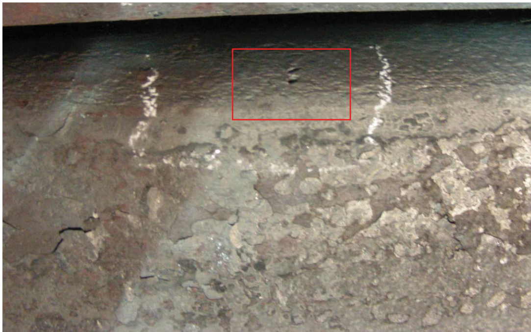
Bild 69: Kantenquerriss geringer Ausprägung, Stahlgruppe 1
