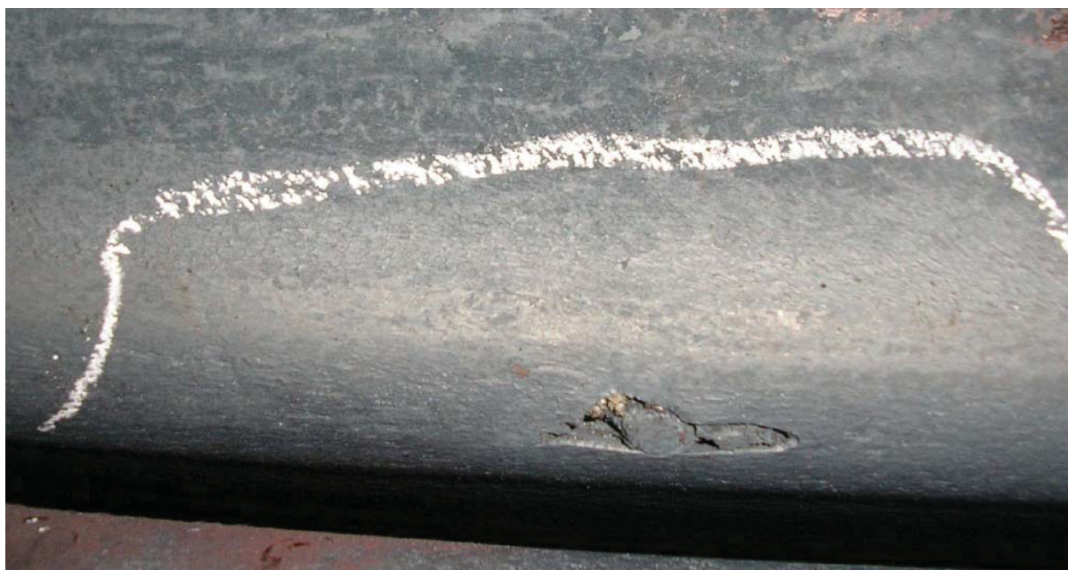
Bild 49: In die Länge gezogener Kantenquerriss auf Knüppel, Bild aufgenommen mittels SIAS, Stahlgruppe 2
