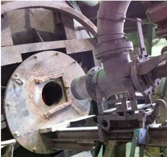
Abbildung 4.3: Am Ende des Konverter installierter Brenner
