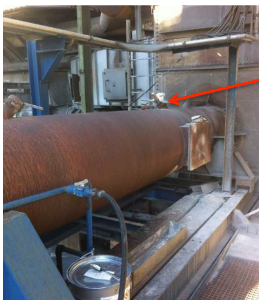
Abbildung 5.18: Darstellung des Abgasrohres mit Messstelle
