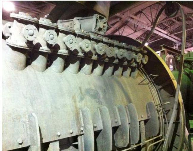
Abbildung 4.4: Blasdüsen am Umfang des Konverters
