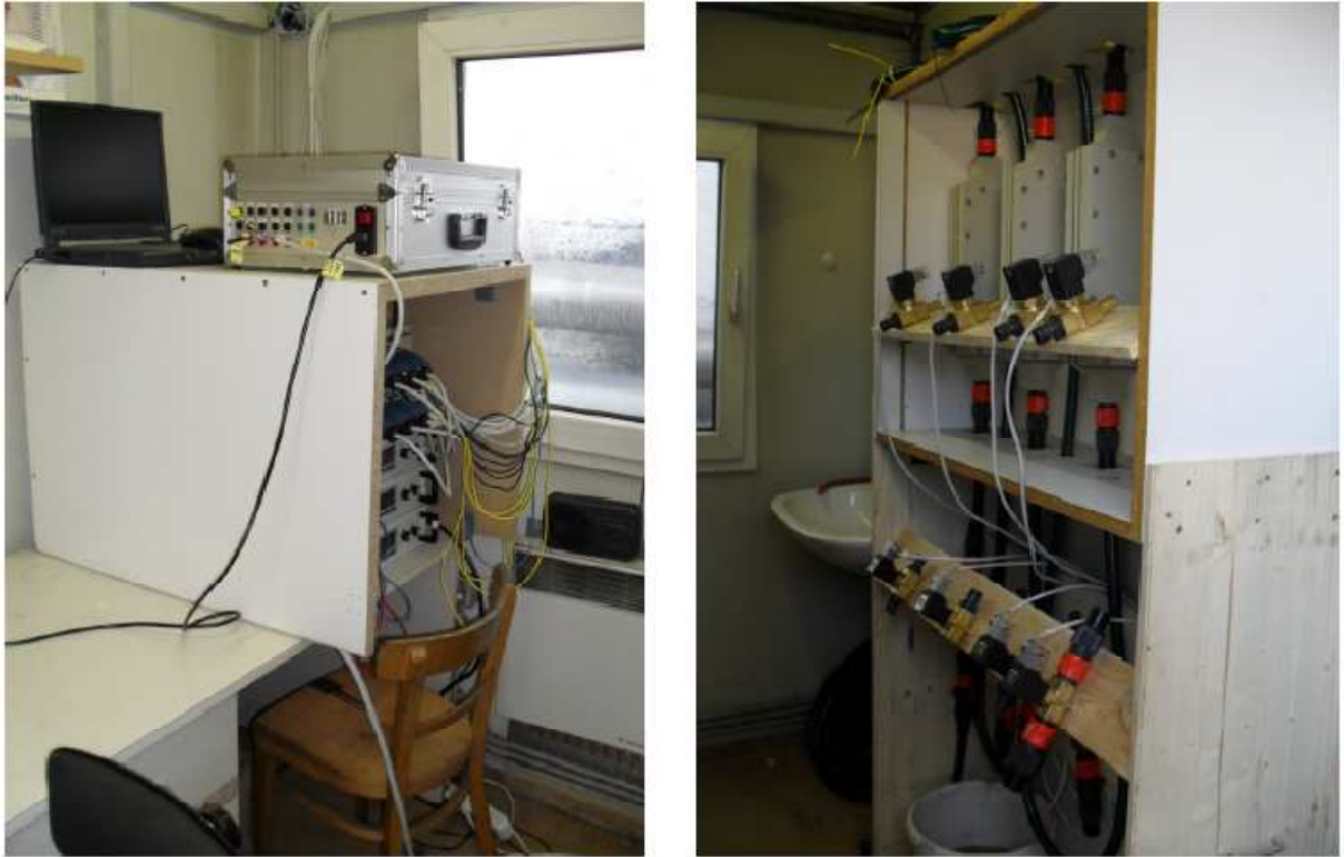
Abbildung 36: Vollständige Technikumsanlage: links: Steuereinheit; rechts: Reaktorraum
