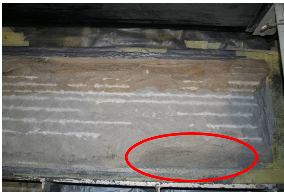
Abbildung 36: Ausbruch des Kantenelements rechts vorne mit einer Tiefe von ca. 11cm
