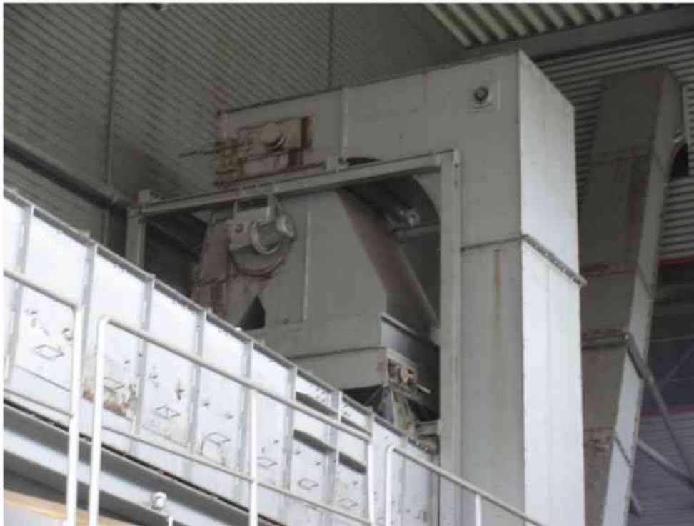
Abbildung 23: Überbandmagnet zur Abscheidung paramagnetischer Stoffe
