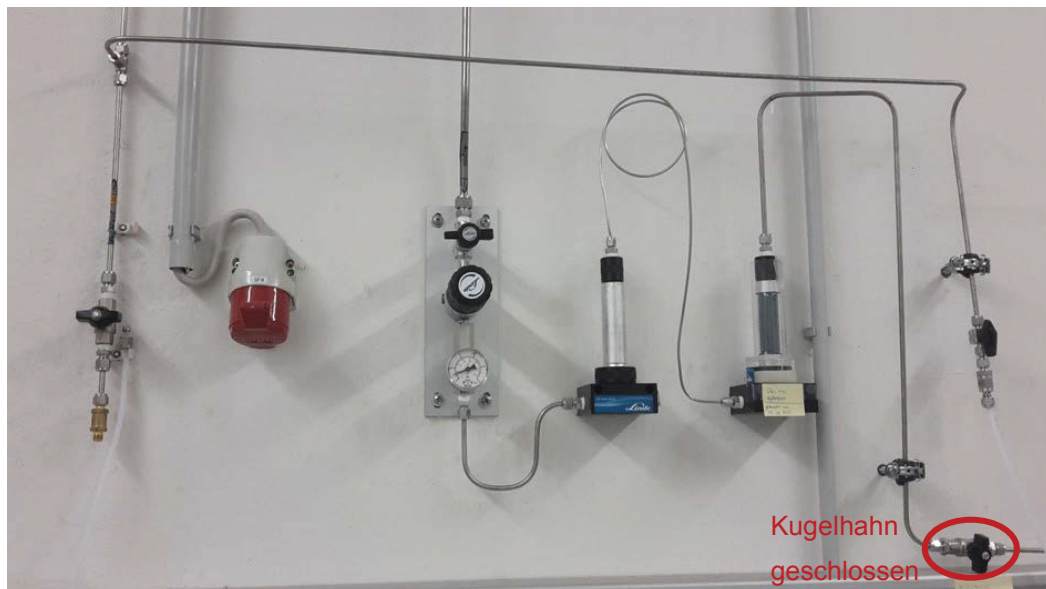
Abbildung 6-1: Gasversorgungssystem mit geschlossenem Kugelhahn.
