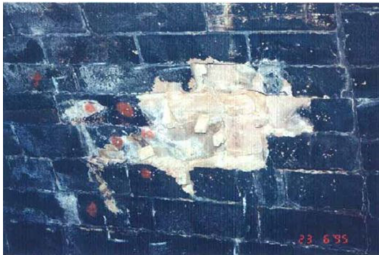
Abbildung 21 - Beispiel für Mauerwerksausbruch 42
