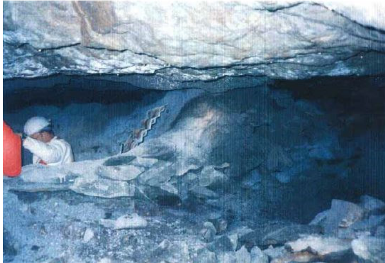
Abbildung 26 - Beispiel für Hohlstelle hinter dem Ausbau 42
