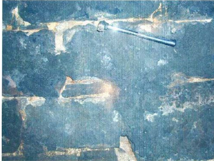
Abbildung 22 - Beispiel für Fugenausbruch 42
