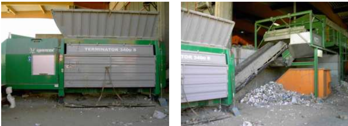
Abbildung 54: Shredder; Shredder, Magnetabscheider und Trommelsieb 80 im Hintergrund
