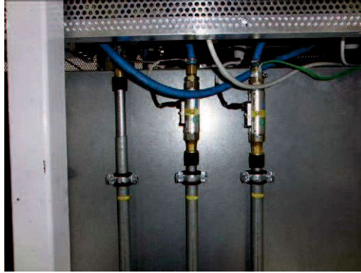
Abbildung 4: Durchflusswächter für Magnetron und Wasserlast.
